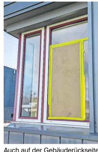
Auch auf der Gebäuderückseite des Schulhauses Bünz matt II wurde eine Scheibe beschädigt.
